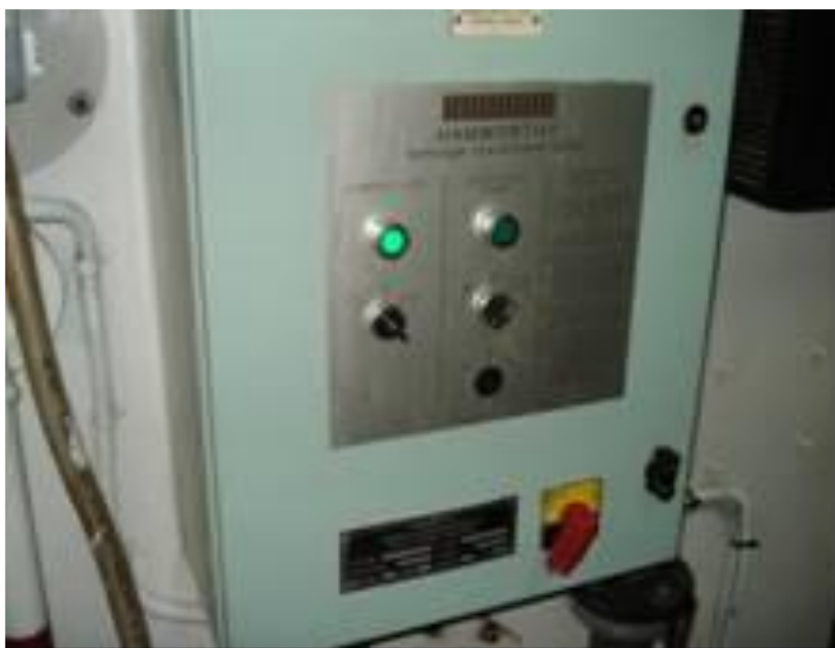
Fig.5. Painel de Controle da ETE. Fonte: FERRARO & CANTARINO (2011)
